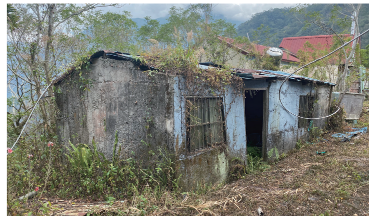
莫拉克毀損之部落房屋。
